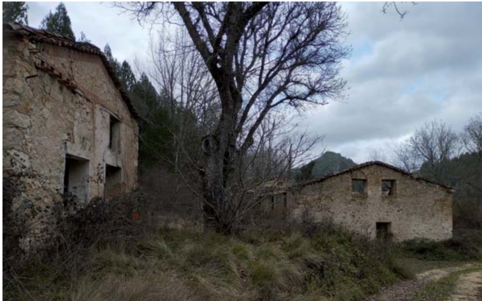
Estado actual del molino de Poyatos.
